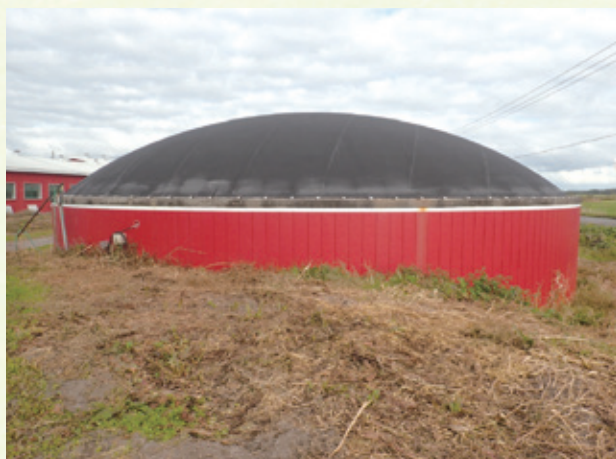
貯留槽兼2次発酵槽
