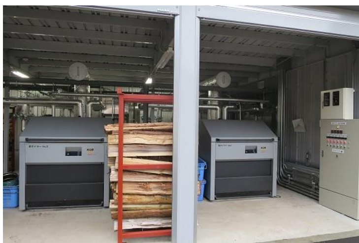
薪ボイラー（黄金泉）
