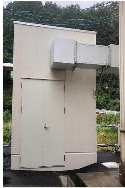
発電機防音庫
