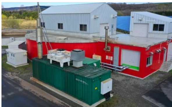
発電タービン施設
