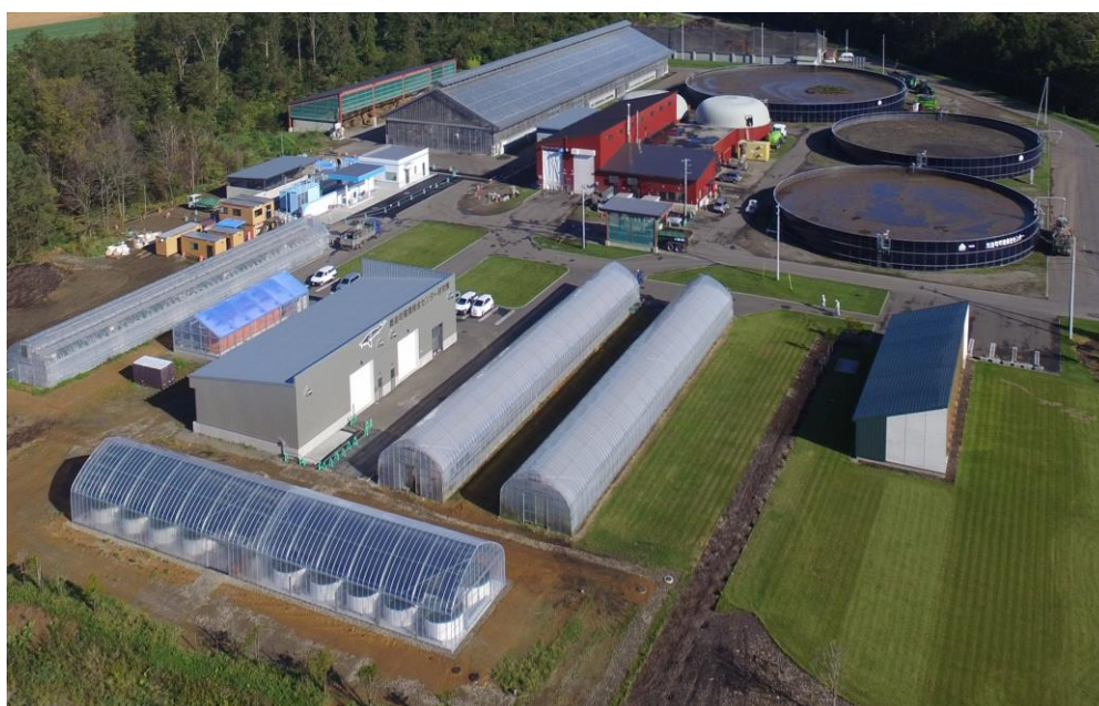
中鹿追バイオガスプラント 全景
