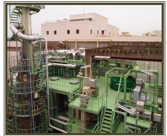
写真:東京都様 過給式(ターボ型)流動燃焼炉
