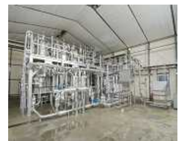
汚泥燃料化装置
